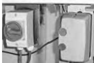
Chave elétrica (alimentação).
